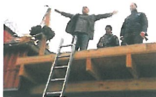
Pfarrer Olaf Maeder hätte zur Feier des Tages offenbar am liebsten alle umarmt. Nach dem Richtspruch der Zimmerleute stieg er selbst aufs Dach. Fotos (2): (Frank Klausmeyer)
